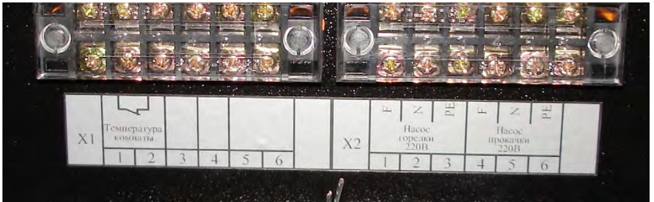
Фото 11в. Подключение дополнительных устройств
